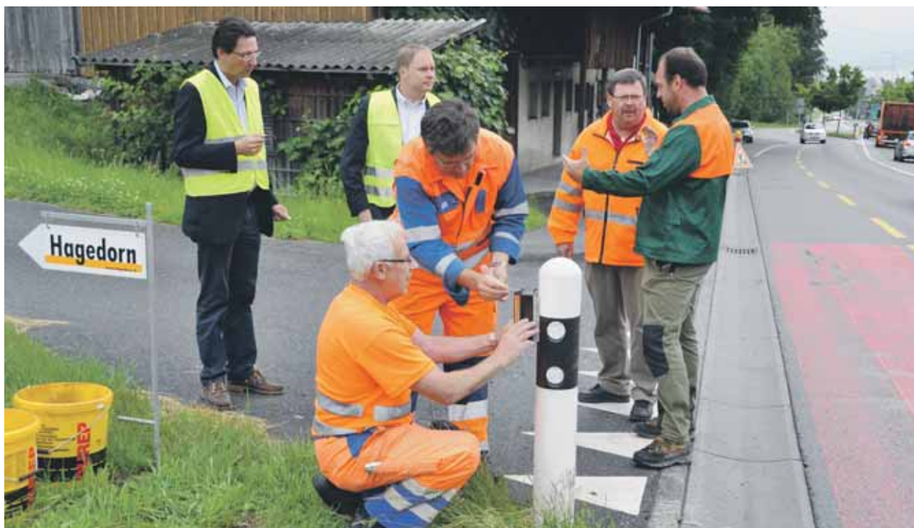
Unter der Aufsicht des kantonalen Wildhüters Steven Diethelm (rechts) montieren die Mitarbeiter des kantonalen Tiefbauamts einen Wildwarner an einem Strassenpfosten entlang der H8 zwischen Pfäffikon und Schindellegi.
